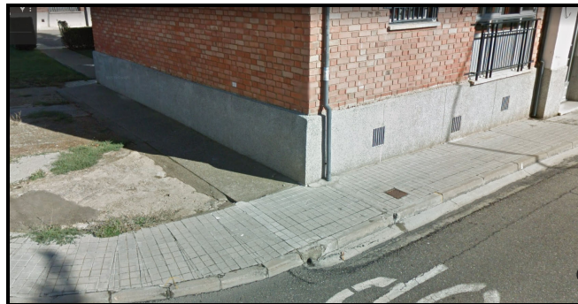
Ejemplo de conexión de caz o al saneamiento ajo acera en Calle Mieres
